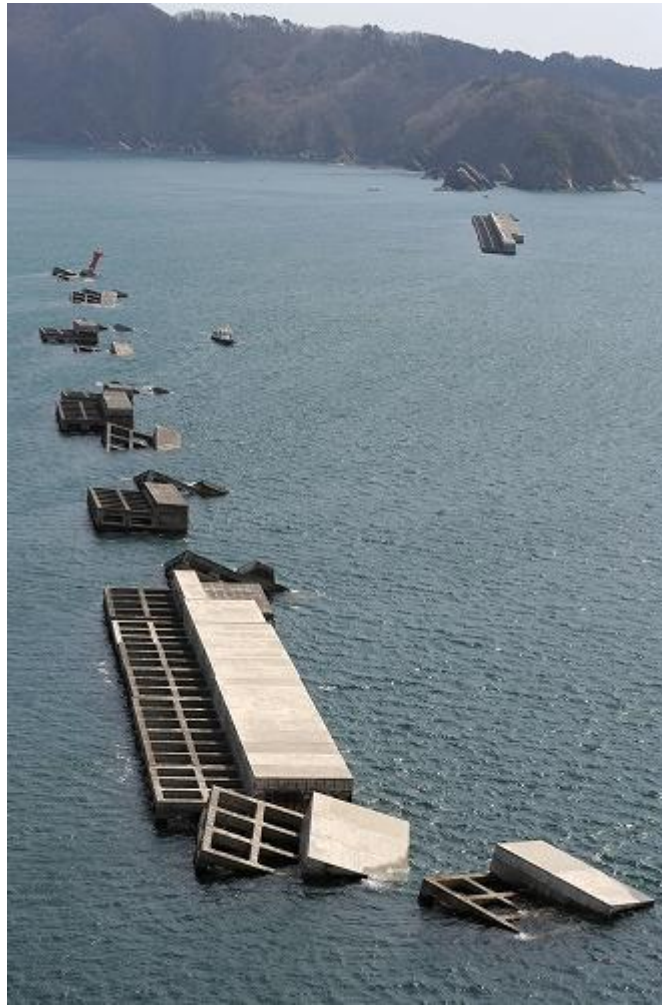
毎日新聞 HP より引用：破壊された防波堤
