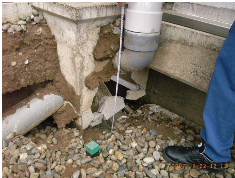
写真 中越沖地震で柏崎刈羽原発に生じた不等沈下
