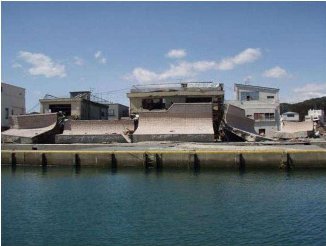
倒壊した山田町の防潮堤 水産庁 HP
